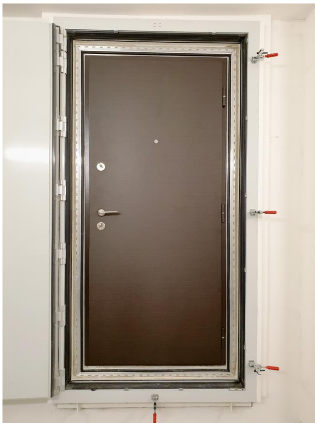
Pohľad na dvere osadené v otvore deliacej konštrukcii akustických komôr
